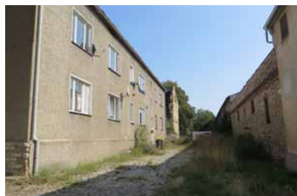
Abb. Leerstehende ehemalige Schnitterkasernen
