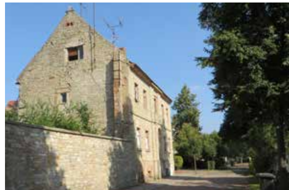
Abb. Baufällige, historische Gutsstruktur im Ortskern
