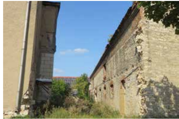
Abb. Baufällige Scheunen in Alter Calbscher Str.
