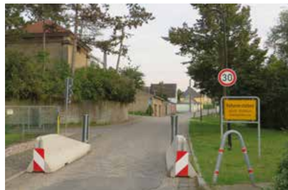
Abb. Sanierungsbedürftige Bodebrücke
